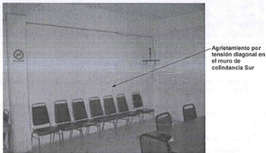
Figura 3 Vista de una grieta por tensión diagonal en el muro del cuarto entrepiso en la colindancia sur del edificio (apertura máxima de la grieta de 1.0 mm)
